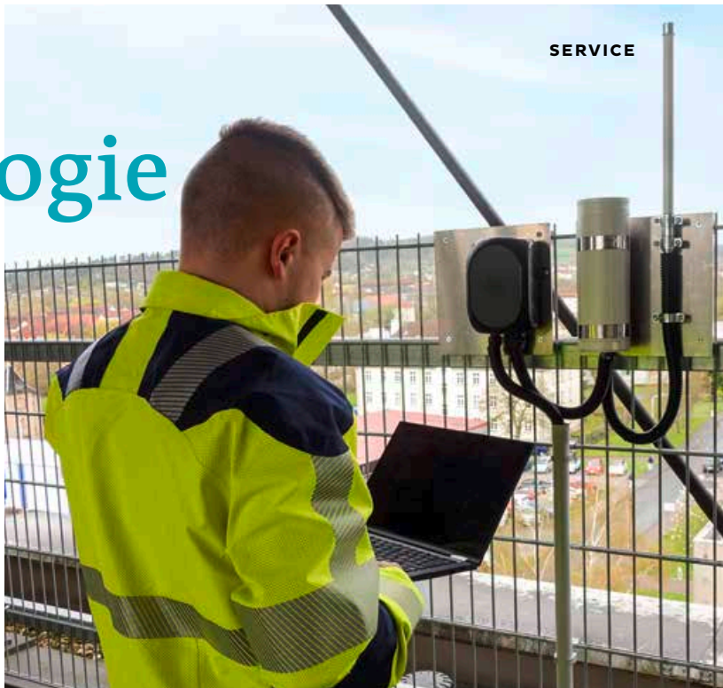
Das Team Messwesen liest über LoRaWAN Verbrauchsdaten aus. Julian Krausse nimmt dafür Einstellungen an einem Gateway vor.
